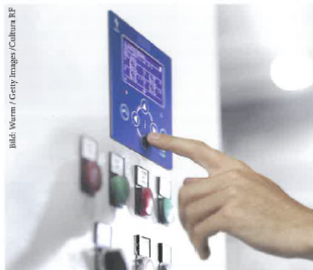
Nicht autorisierte Parametervstellungen müssen nicht nur im Rahmen der Anlagensteuerung und Gebäudetechnik, sondern auch auf Anlagen- und Geräteebene wirksam unterbunden werden.
