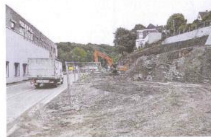
Der Erweiterungsbau der Firma Wurm wird terrassenförmig mit sechs Ebenen an der Morsbachtalstraße entstehen. Foto: Michael Sieber
