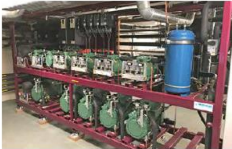
„RoxstaIndustrial“ mit fünf NK-Verdichtern und sechs TK-Verdichtern von Bitzer
