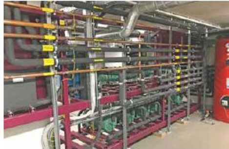
Die Abwärme der Kälteanlage wird zum Vorheizen des Spülmaschinenwassers verwendet. Rechts im Bild einer der 500 l-Speicher von DK
